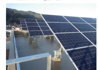
太陽光発電設備(屋上)
