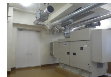
自家発電機室
