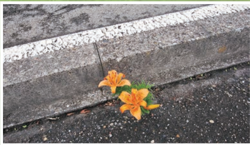
さそり座のわんこさん ど根性ユリ、コンクリートの間から綺麗に咲いていました! (国道 45 号沿い歩道)
