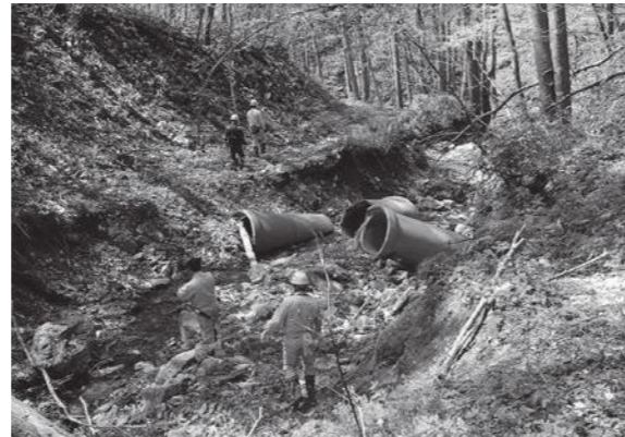
台風により破壊された作業道
