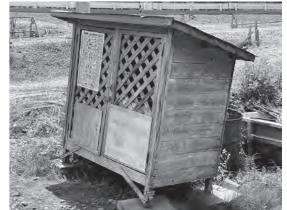
野生動物に壊され修理したごみ集積箱。早期の更新が待たれる
