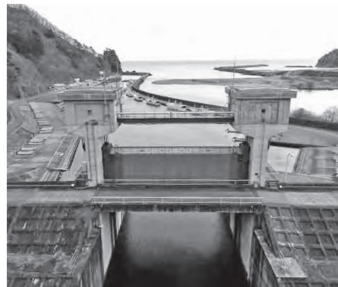
緊急時に備え、水門の補修を早急に
