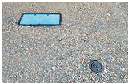
メーターボックス（左上）と止水栓（右下）
